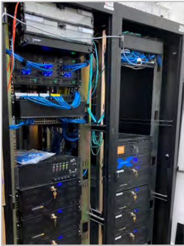
Nouvel équipement de tête de réseau pour le système de vidéosurveillance au Palais législatif du Manitoba
