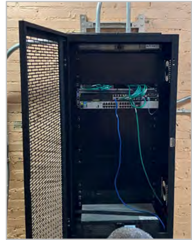
Nouvel équipement de réseau pour le système de vidéosurveillance à la résidence du lieutenant-gouverneur
